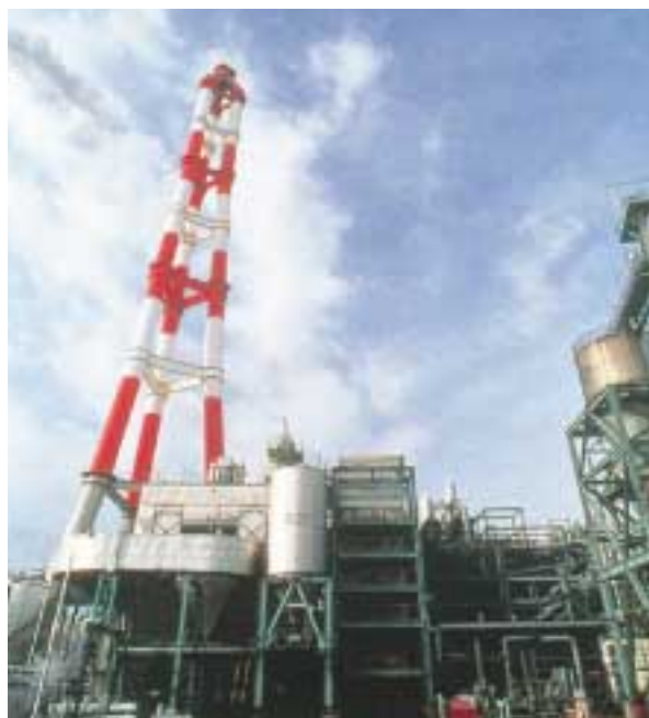
独自技術による排煙脱硝設備
