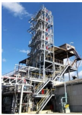
④ ケミカルリサイクル実証設備
