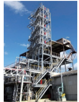
ケミカルリサイクル実証設備 Chemical recycling demonstration facility
