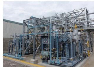
CO 2 からメタノールを高効率に製造するパイロット設備 Pilot facilities manufacturing at high efficiency methanol from CO 2
