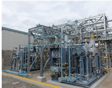
CO 2 からメタノールを製造するパイロット設備
