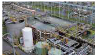
活性汚泥処理施設
