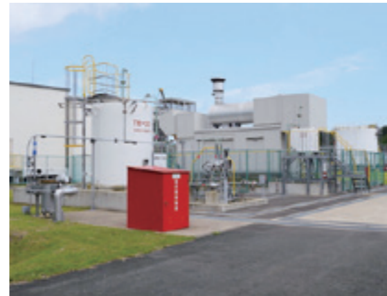
非常用発電機
