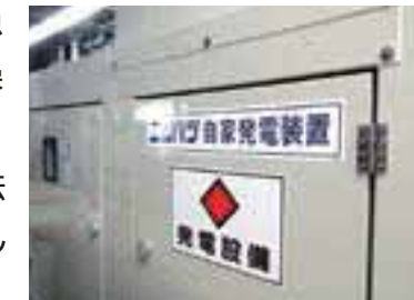
緊急用自家発電装置
