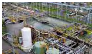
活性汚泥処理施設
