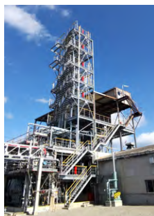
PMMAケミカルリサイクル実証設備
